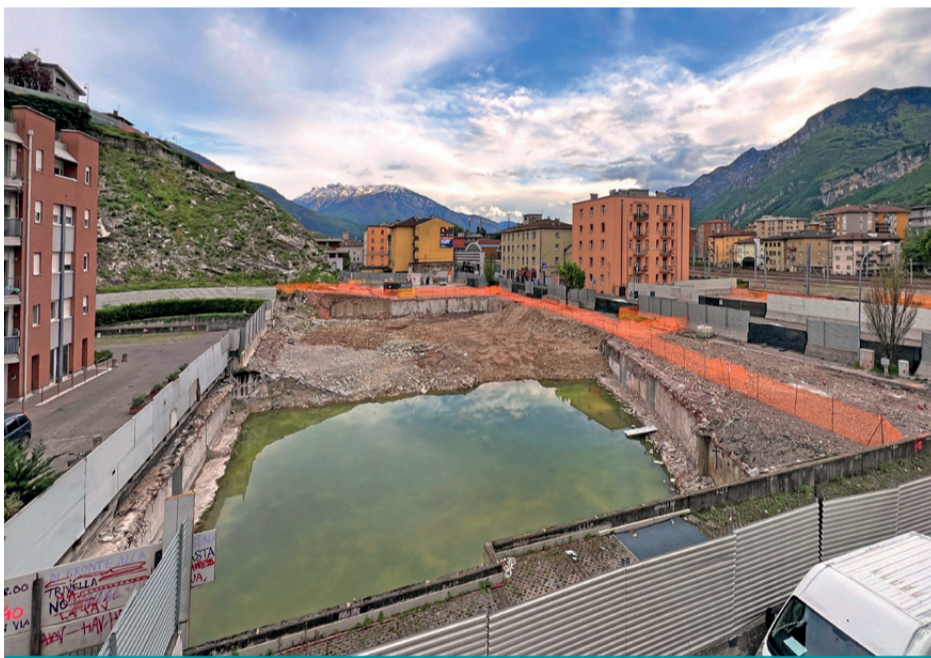
Il cantiere ferroviario di via Brennero "allagato" dalle piogge dei giorni scorsi
